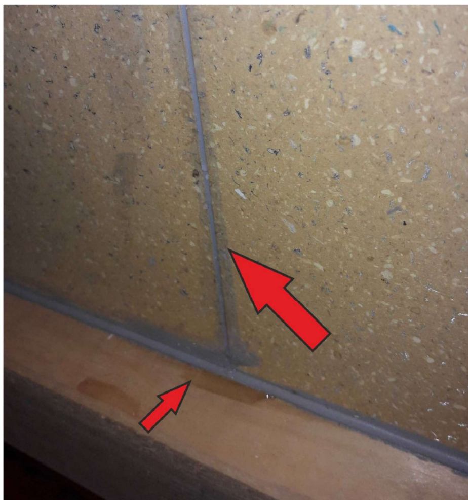
zaobserwowane miejsce przecieku
